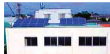
太陽電池145w×36枚設置（5.22Kw）
