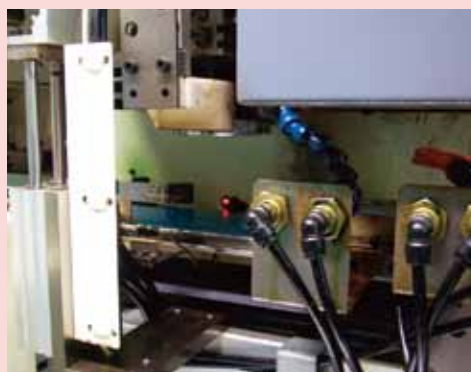
切り粉を自動除去する機構を組み込んだ設備
