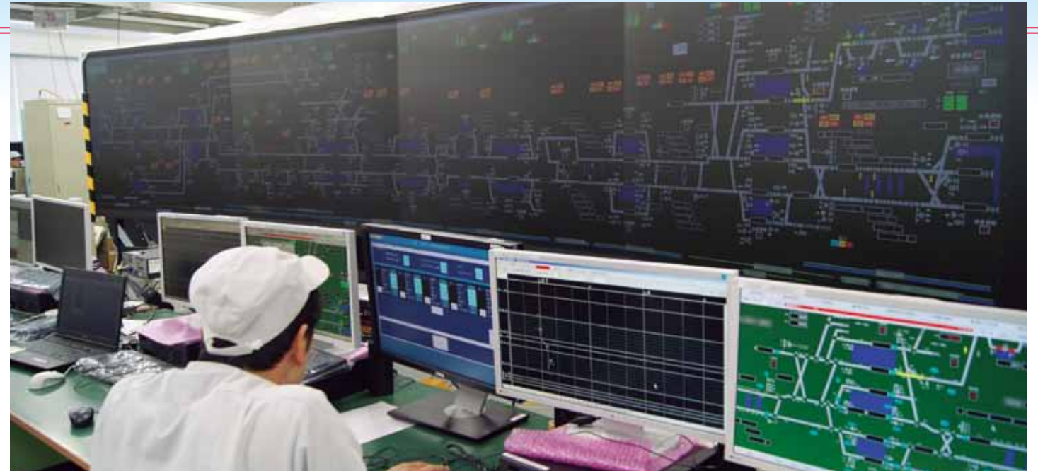
列車運行管理装置：ダイヤに基づいた自動進路制御や、運行状況などの運輸司令業務に必要な情報を提供する
