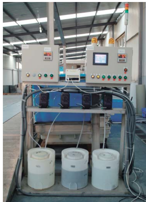
独自の三価化成処理自動補給装置で高レベルの 処理液管理を行なっている。
