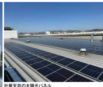
社屋天井の太陽光パネル （本社の40%を太陽光で補っている）
