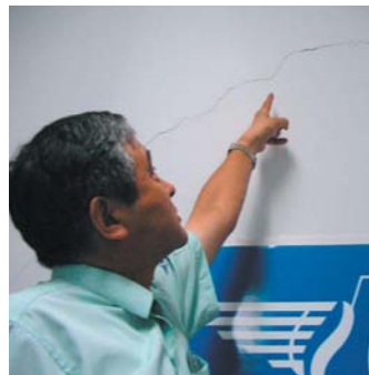
よくある話ですが…壁のひび割れにがっかりのフィルターメーカー・ケンブリッジフィルター（上海市）の津田総経理
