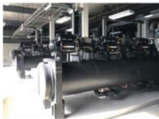
関西電力のチラーシステム
