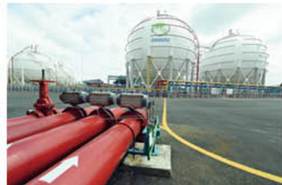
WP エナジーの貯蔵施設
